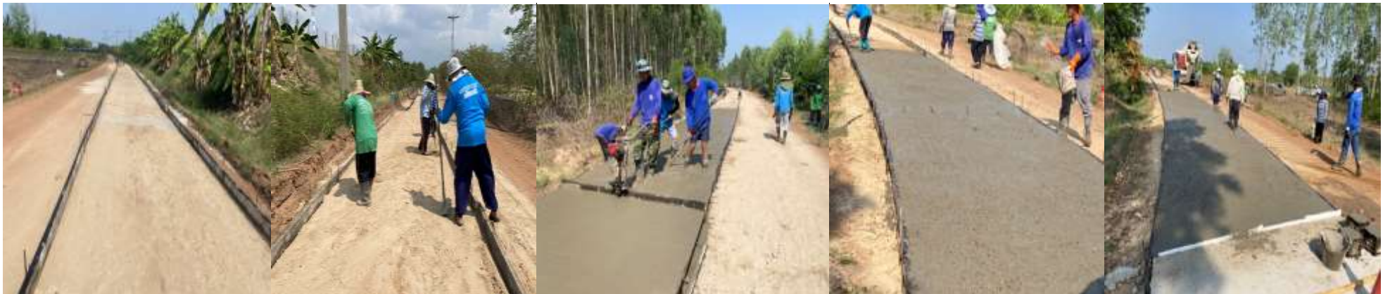
โครงการก่อสร้างถนนคอนกรีตเสริมเหล็ก รหัสทางหลวงท้องถิ่น นม.ถ.๒๕๔-๐๒ สายต่อน้ำ เทศบาลตำบลแหลมทอง
